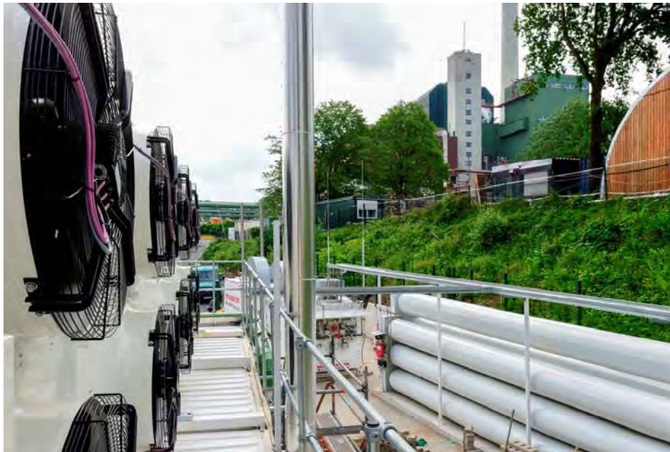
AWG Wuppertal, Wasserstoff-Produktion, Quelle: AWG Wuppertal
